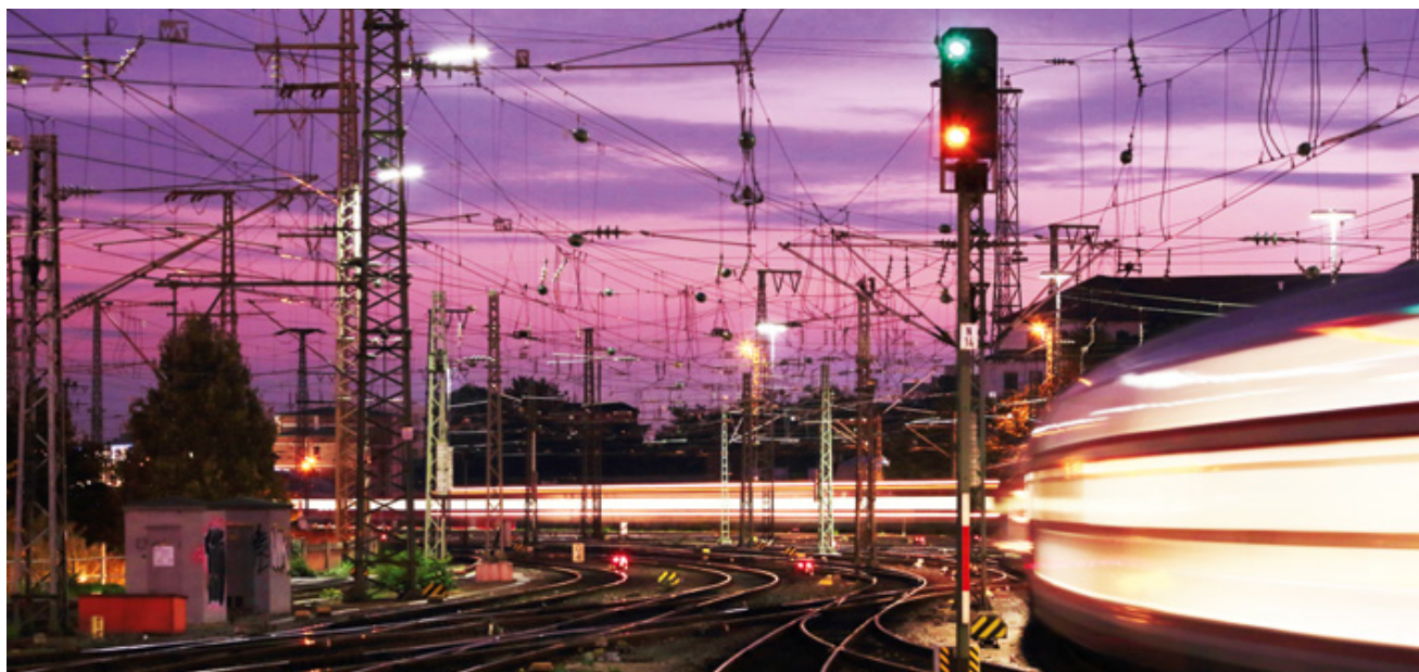
Sorgen für Sicherheit auf der Schiene: Lichtsignale. Hier bei der Einfahrt zum Münchner Hauptbahnhof.
